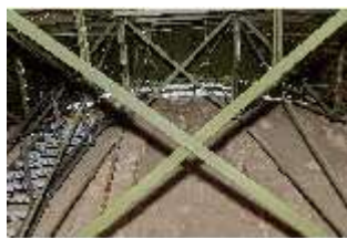
KeBf.II, Dachboden, DI014213, BSV-
