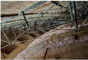
KeBf.II, Dachboden, DI029152, BSV
