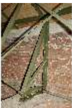
KeBf.II, Dachboden, DI014212, BSV-
