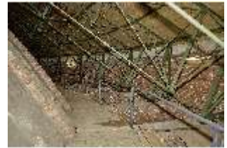
KeBf.II, Dachboden, DI014207, BSV-
